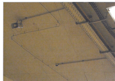
Bild 19: Linear-Brandmeldekabel (siehe Pfeil) und Lautsprecher an der Tunneldecke
