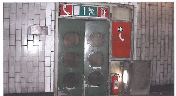
Bild 6: Fluchttüren in Tunnelmittelwand mit Notrufstation und Handfeuerlöscher
