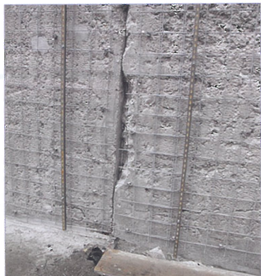
Bild 13: Schadhafte, stark ausgebrochene Fugenflanken
