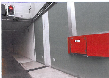
Bild 20: Feuerwehrschränke am Tunneleinfahrtportal
