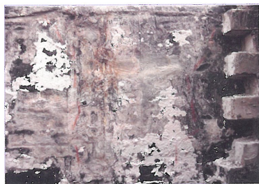
Bild 3: Zur Schadensklärung örtlich im Übergang Wand zu Decke freigelegte, im Fugenbereich schadhafte Bitumenabdichtung
